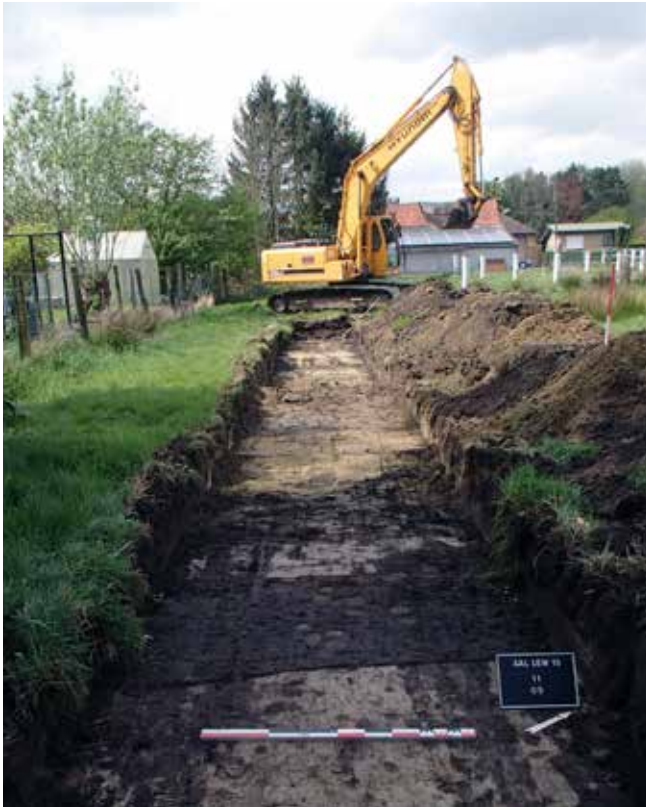
Figuur 21: Het diepste punt van de depressie was aangevuld met verschillende heterogene pakketten, waarin ook een betonnen afvoerbuis geplaatst was
